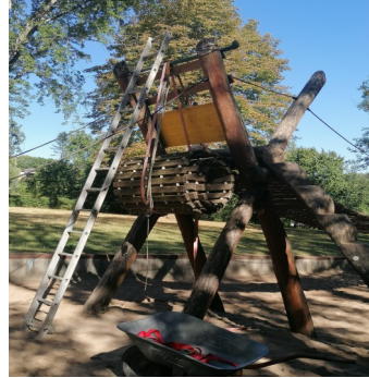
Brücke im Park zerrstört
